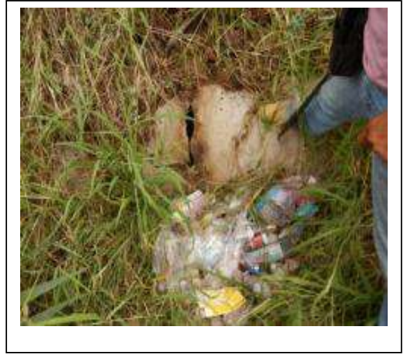
Se observa de forma general y detalle las separaciones y fracturas en juntas del colector. Calle: General Plutarco Elías Calles Georreferencia: 16.3374248814,-95.234418335
