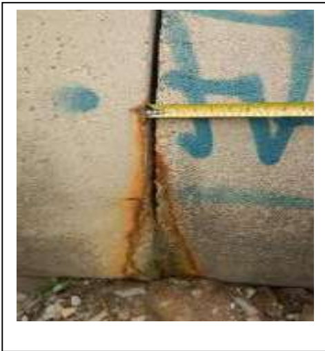
Colector con separaciones y fracturas en juntas. Calle Guadalupe Victoria. Georreferencia: 16.3297900,-95.233221225
