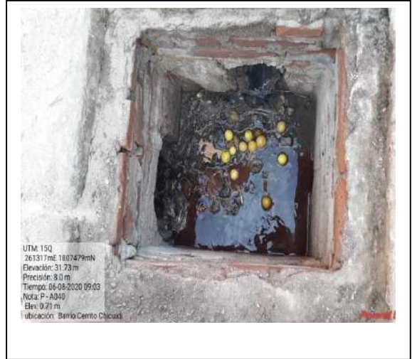
pozo de visita colapsado. Calle Técnica. Georreferencias 16.339285602,- 95.218273
