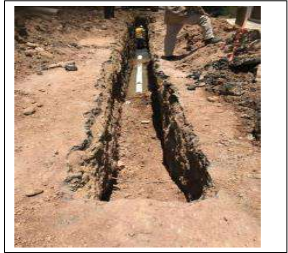
Tubería de concreto simple colapsada que generó infiltraciones y fugas de agua residual, tratando de optimizar con tubería por PVC en calle Zaragoza. Georreferencia: 16.32826159,- 95.231385430
