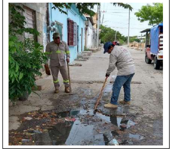
Red de atarjeas colapsada y derrame de aguas negras sobre la calle. Por que lo que se realizan trabajos urgentes de desazolve Calle: 10 de mayo: Georreferencia: 16.3446451431, -95.2190905064
